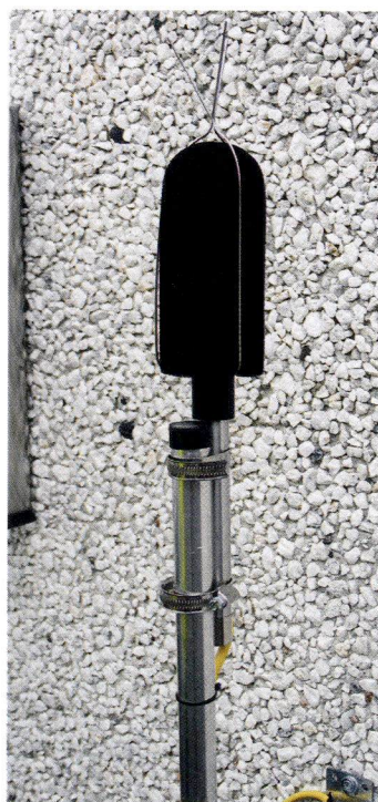
↑ APL Systemsin äänitarkkailujärjestelmä varmistaa, että laitoksen melutaso ei nouse.
