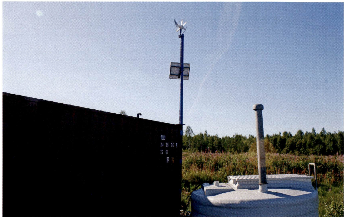
↑ Dieselaggregaattikontti, jonka automatiikka ja akkujen lataus hyödyntävät uusiutuvaa energiaa.
