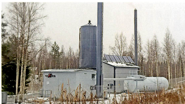
↑ Viime vuonna rakennettu Tahkavuoren Nipasen aurinko-pellettilämpökeskus.
