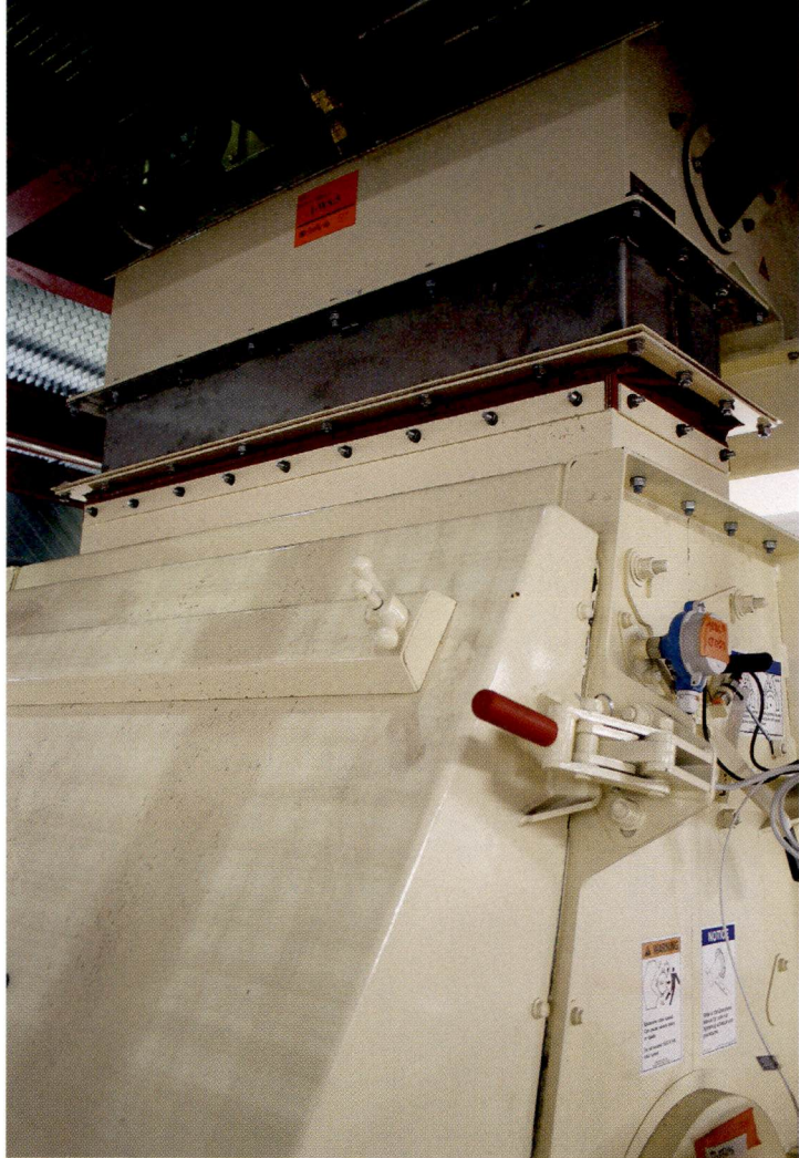
↑ Myllyjä on ainoastaan yksi, joten sen vikaantuminen pakottaa siirtymään varapolttoaineeseen.
