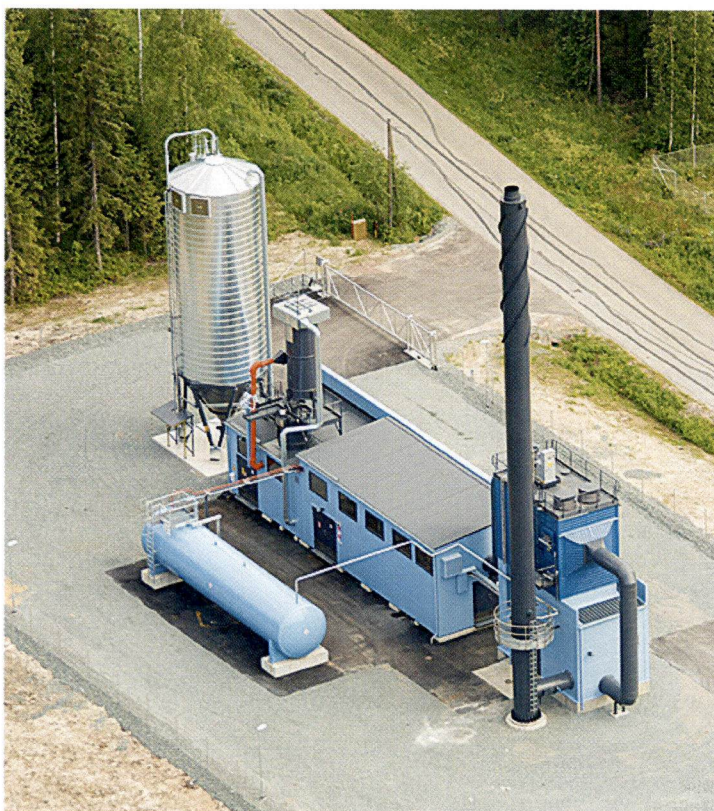
↑ Lapinlahden 7 megawatin pellettipölylämpökeskus käynnistyi 2013.
