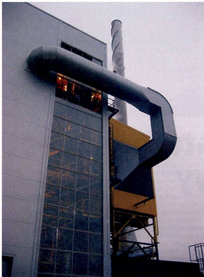
Putkimaan 25 MW leijupetikattilassa käytetään erikoispetimateriaalia, joka pärjää myös vanerituotannon sivutuotteiden kanssa.
