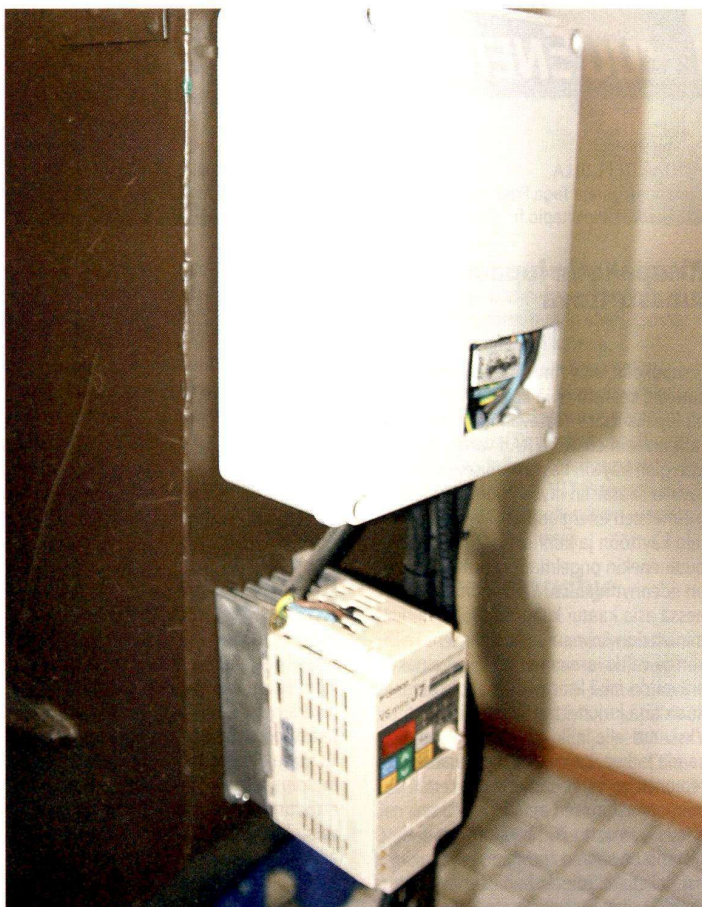
Ohjauskeskuksen toiminta perustuu jaksoaikareleeseen ja kolmeen kontaktoriin. Laite käy eri polttoaineille tehdyn esiohjelmoinnin mukaisesti. Ohjauskeskukseen saa gsm-modeemin, jolloin häiriöt välittyvät haluttuihin numeroihin tekstiviestein. Ohjausohjelma voidaan tällöin päivittää myös etäyhteydellä.
