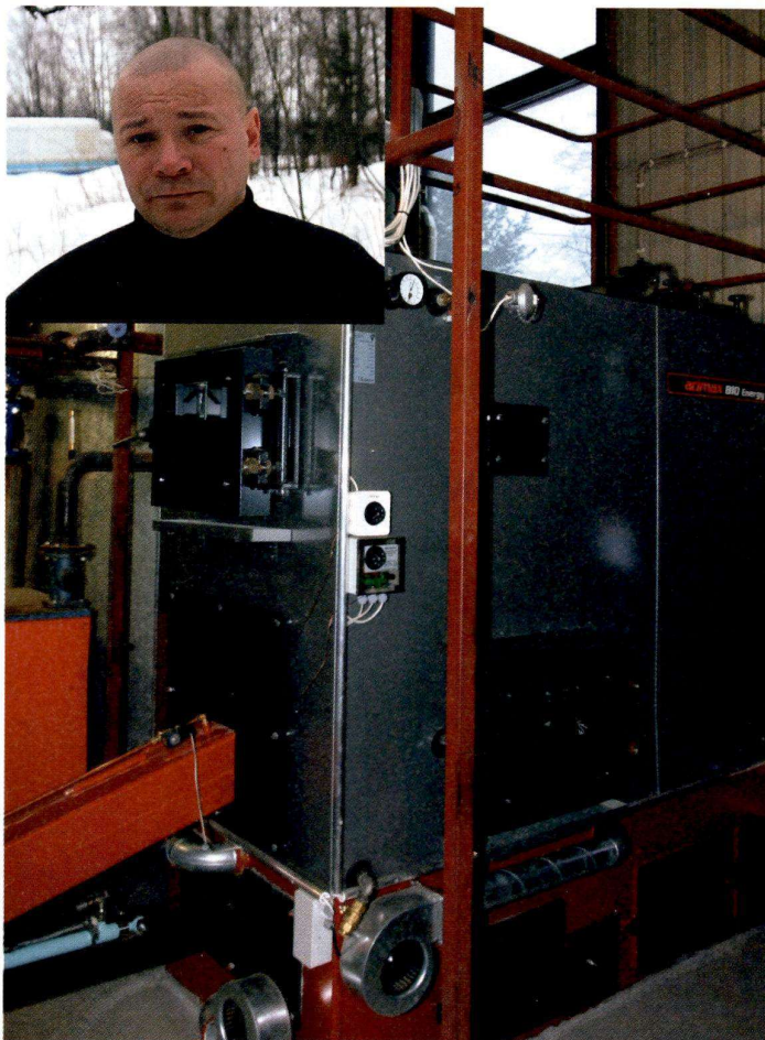
Uusi kattila syöttölaitteineen saatiin entiseen tilaan, jonne jäivät myös öljykattila ja varaaja. Kattilalle on metalliraput ja riittävästi hoitotilaa sen yläpuolella. Hyvönen aikoo tehdä konvektioon nuohousautomaatin, jonka kiinnitykseen voi käyttää hoitoluukkujen pultteja.
