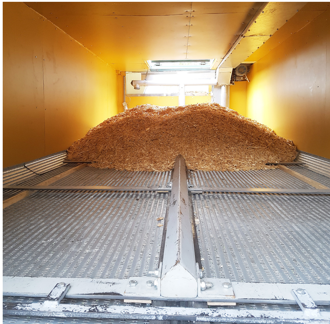
↑ VTT:n aurinkokuivuri sisältä.
