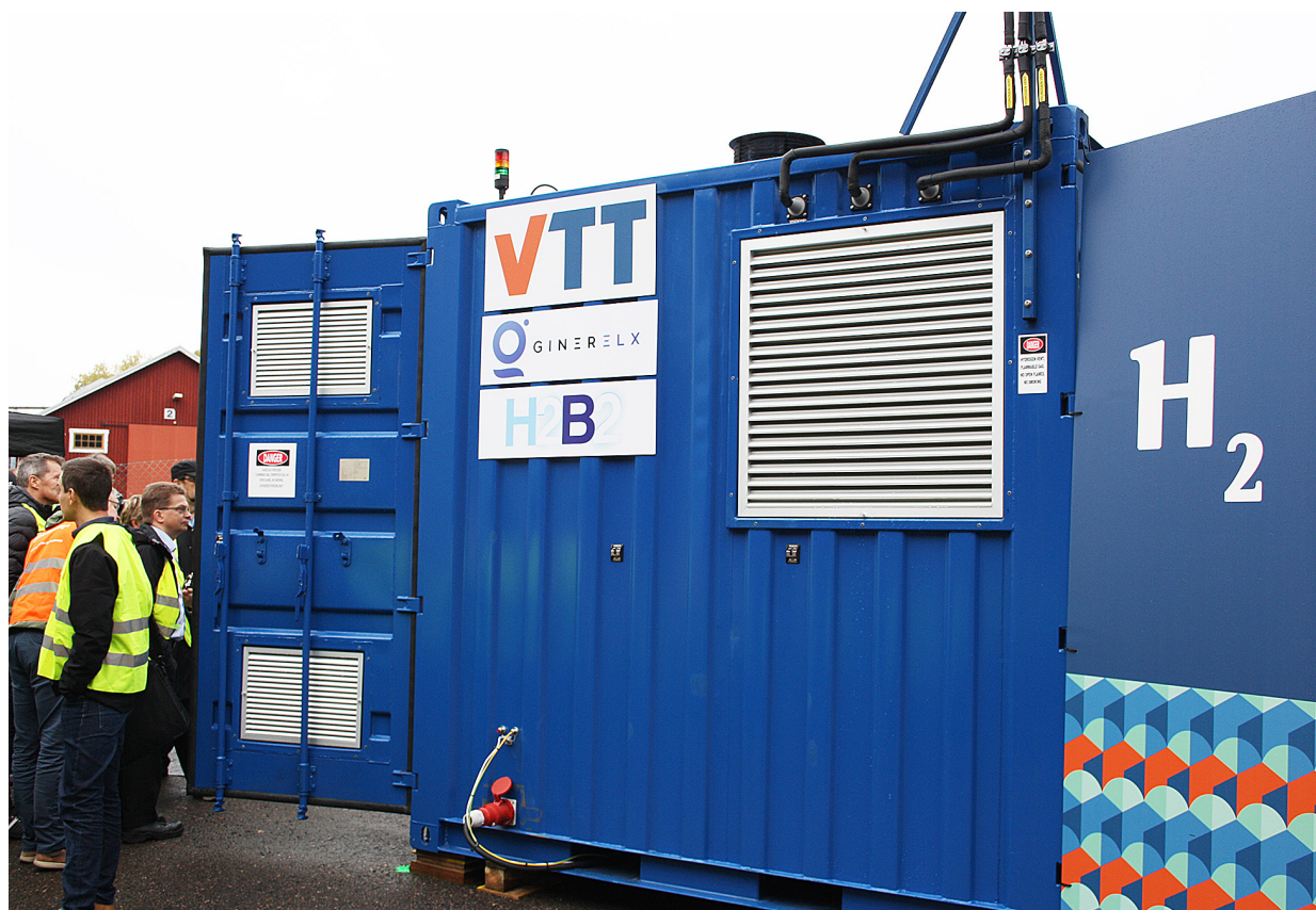
↑ Tekniikka on sijoitettu kolmeen konttiin.
