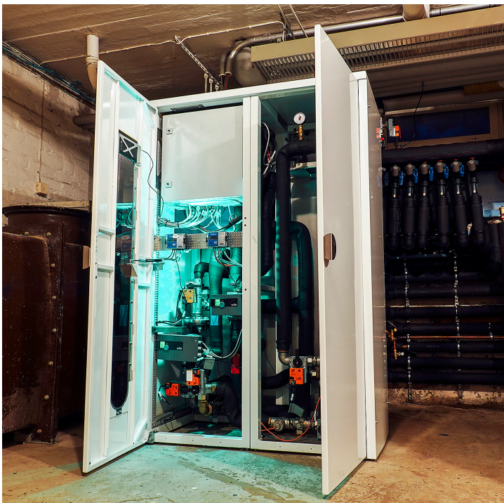
↑ Yksi järjestelmän kolmesta osasta on ohjain, joka valvoo lämmön lähdettä ja ohjaa lämmön varastointia ja käyttöä.
