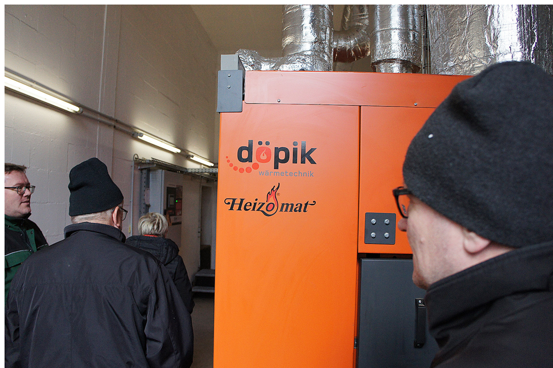
↑ Osuuskunnan 800 kW hakekattila. (Kuva: Kari Laasasenaho)
