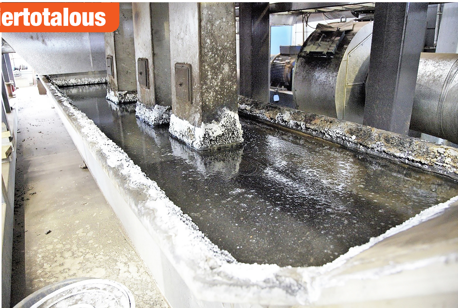
↑ Vedellä täytetty pohjatuhkan sammutusallas.
