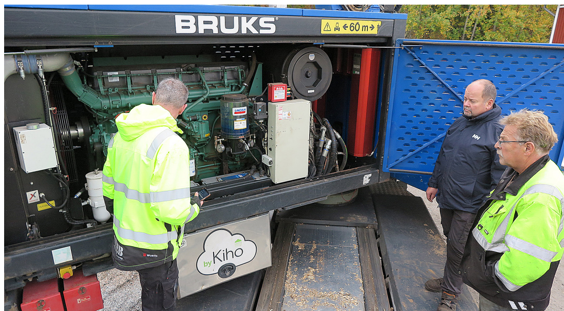
↑ Moottoritilassa on sähköä ja palokuormaa lähellä toisiaan, kun kone on käynnissä. Vasemmalta Sivebin Krister Lindström, Sawcenterin Björn Backman ja Flisapin Ari Lehtovirta.
