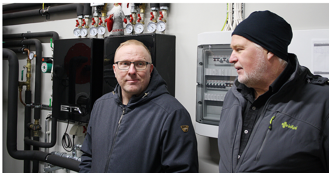
↑ Pro Agrian Juha Hiitelmä (oikealla) korostaa, että kattiloiden tekniikka on kehittynyt viimeisen vuosikymmenen aikana melkoisesti parantaen lämpölaitosten hyötysuhdetta.
