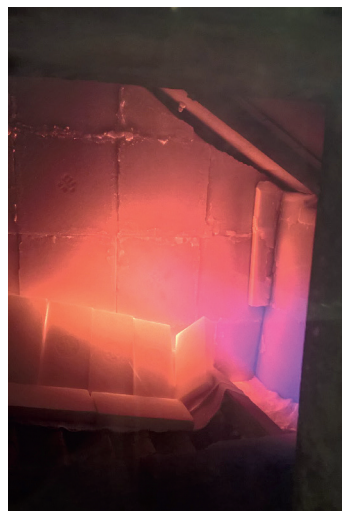
↑ Lämpötila kattilan palotilassa alkaa olla kohdallaan.
