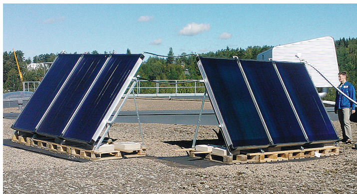
↑ Savosolarin toimittamat aurinkolämpökeräimet VTT:n Jyväskylän toimipisteen katolla. Keräimien avulla tutkitaan aurinkolämpöön perustuvaa biomassan kuivaamista.
