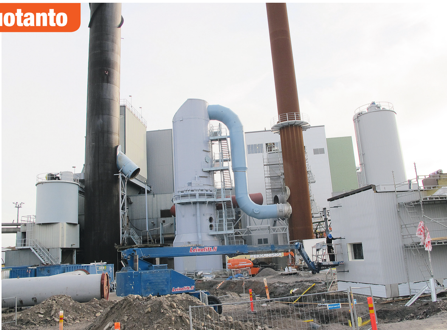
↑ Tolkkisten voimala 2012, joka valmistui 2013. Sen jälkeen ei ole valmistunut uusia puuta käyttäviä CHP-laitoksia. Syksyllä 2017 valmistuu Naantalin laitos, jonka jälkeen ei ole tiedossa uusia investointeja CHP-tuotantoon.
