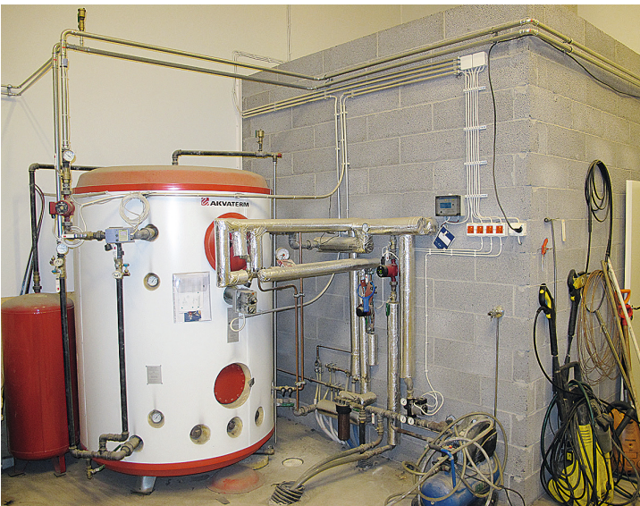
↑ Rakennuksen sisäpuolella näkyy kattilahuoneen mitat sekä kahden kuutiometrin vesivaraaja.
