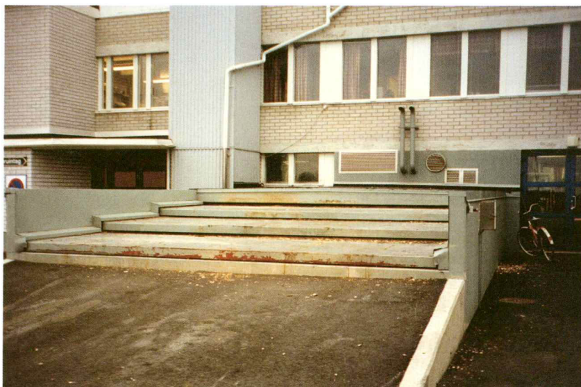
Koulun yhteydessä rakennettu lämpökeskus ei näy päältä, vain hakesiilo näkyy ulkopuolella.
