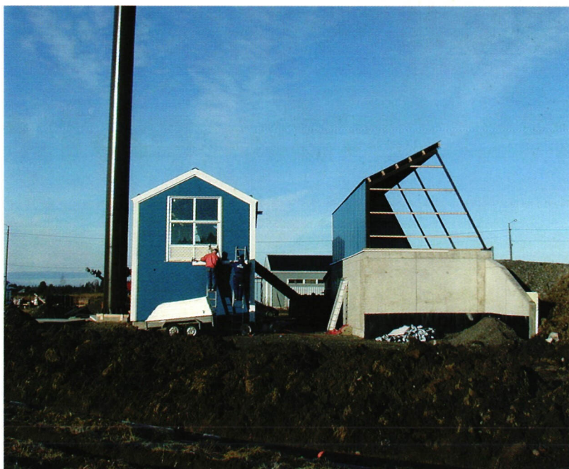
Viime marraskuussa otettiin käyttöön Pukkilan lämpökeskus.
