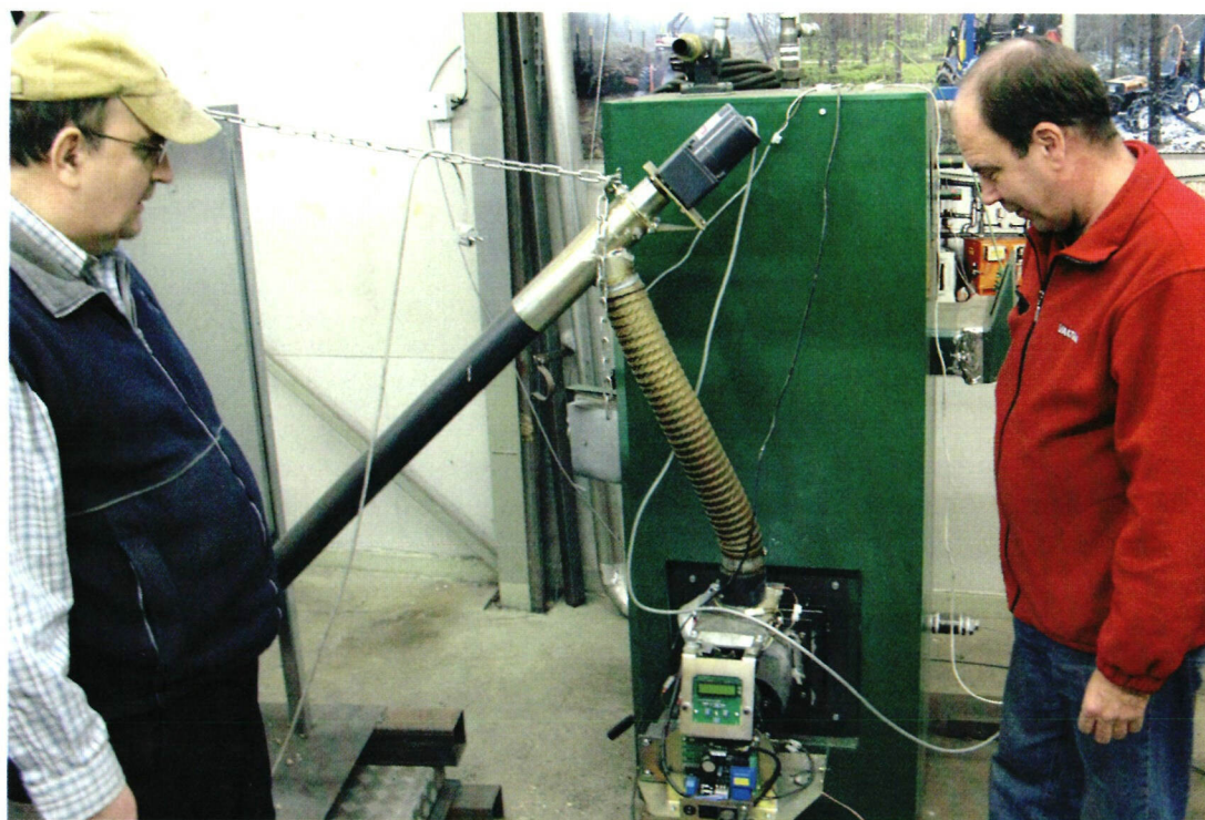
↑ Pudotusputki oikeassa kulmassa, polttimessa sulkusyötin ja pinnanvartija niin turvallisesti ja varmasti toimii, toteavat Jyrki Kouki (vasemmalla) ja Kari Vuorio.
