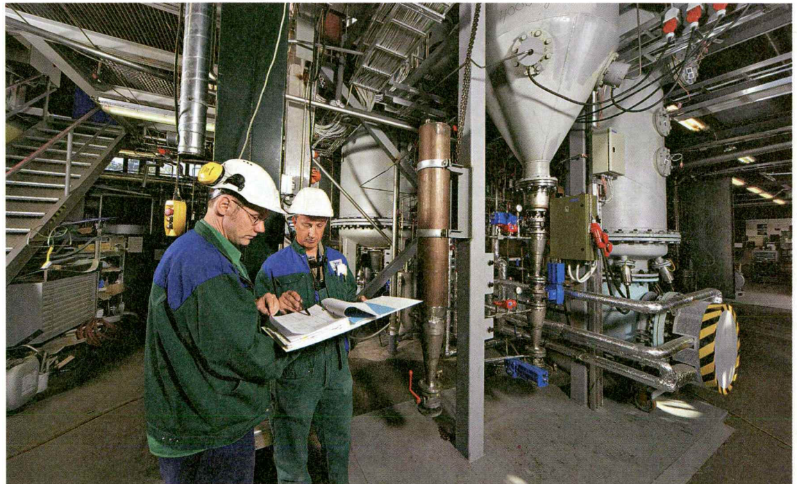
VTT:lle valmistui lokakuun puolivälissä Otaniemeen 500 kW:n koelaitteisto, jolla eri materiaalien kaasutusta ja kaasun puhdistusta pystytään tutkimaan todellisissa oloissa. Kuvassa laitteiston äärellä tutkimusinsinööri Jarmo Rutanen (vas.) ja tutkimusavustaja Tom Gustafsson. Kuva Antonin Halas.
