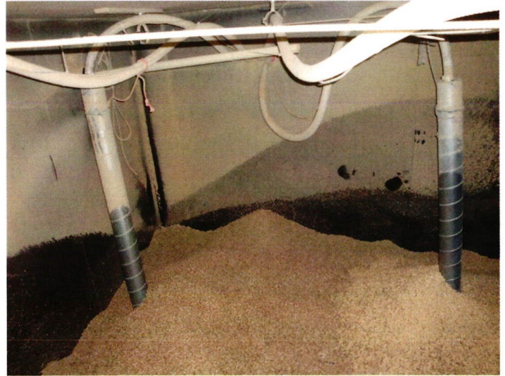
↑ Pellettivarastossa on neljä tärymoottorilla varustettua imuputkea.
