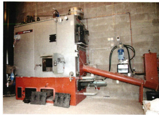
← Kalkkunat olivat jo teuraspaikassa, joten lämmöntarve oli pienimmillään. Kattila on sammutettu ja puhdistettu. Lämmitys aloitetaan uudelleen sitten, kun uudet untuvikot ovat saapuneet.
