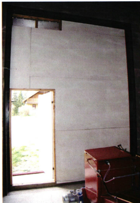
↑ Kattilahuone on avara, tila riittää joka suuntaan. Ja jos olemassa olevan kattilan rinnalle halutaan toinen, seinää ei tarvitse piikata auki, riittää kun irrottaa levyt ja seinäpellit.
