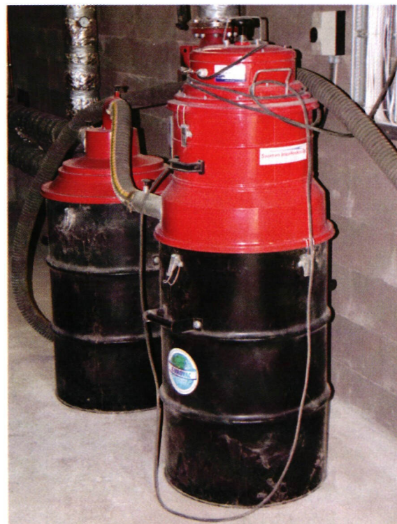
↑ Tuhkanpoistoruuvi siirtää osan kattilaan kertyvästä tuhkasta, imurilla hoidetaan loput.
