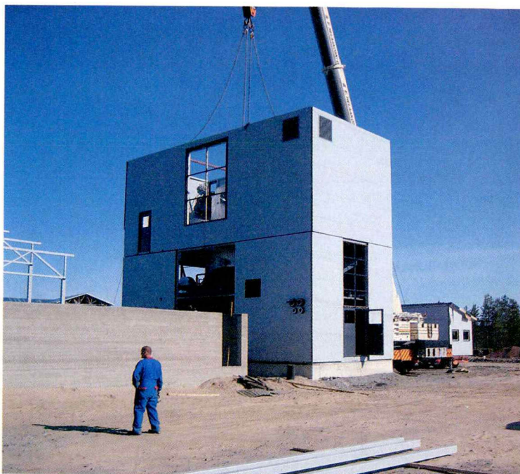
Kotimarkkinoilla lämpölaitokset ovat ykköstuotteena. Pyyn saha ja Höyläämö Oy:n BioEnergy 4,2 MWth kompakti lämpölaitos on käyttöönottoaiheessa ja luovutetaan asiakkaalle lokakuussa. Kattilalaitos on teholtaan 4,2 MW.
