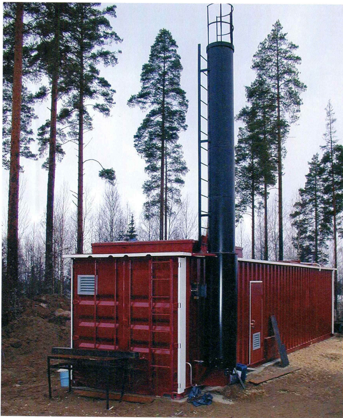
Lämpöyrittäjäkohteissa on kontteja ja paikalle rakennettuja lämpökeskuksia. Kuvassa Tulostekniikka Oy:n 300 kW:n kontti Syötehuviat Oy:n teollisuusalueella.
