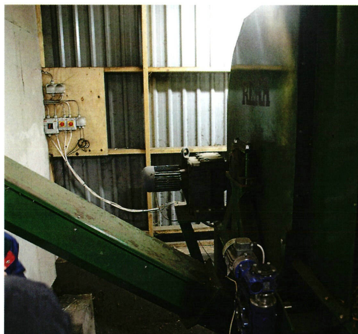
↑ Paalit hajotetaan ja olki silputaan hidaskierroksisessa rummussa vastateriä vasten. Silppu viedään kattilaan järeillä ruuveilla sulkusyöttimen kautta.
