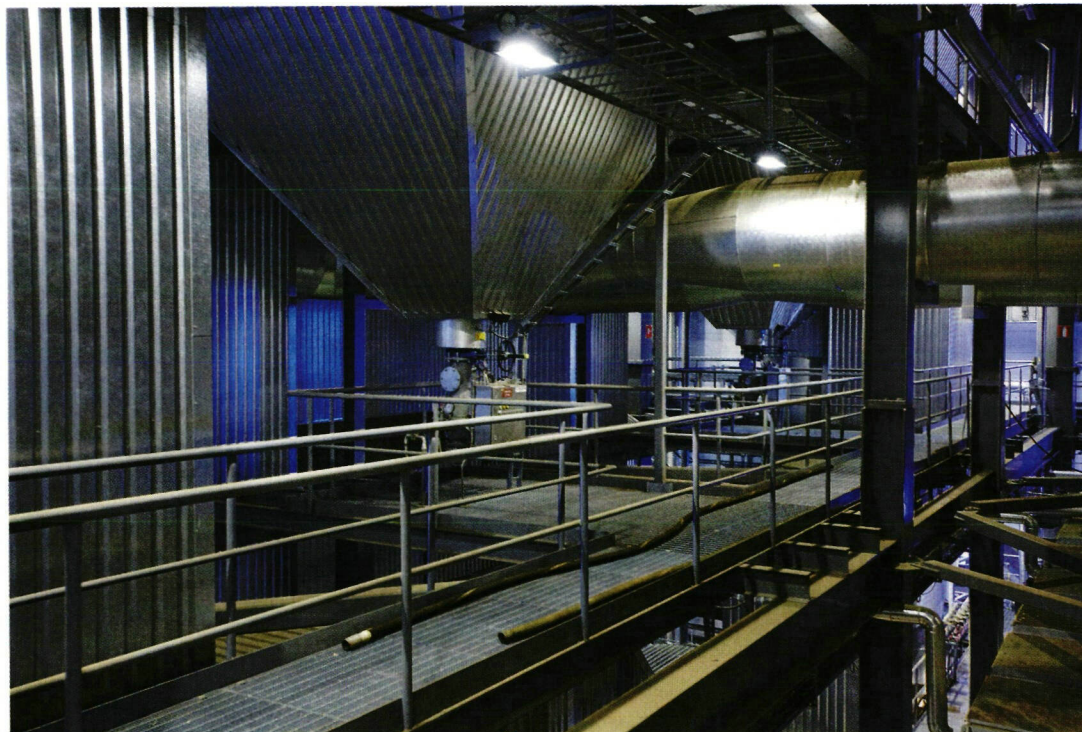
↑ Laitokseen valittu kiertopetikattila täytti osaltaan laitoksen molemmat tärkeät vaatimukset, sillä se mahdollistaa laajan polttoainevalikoiman käytön matalalla päästötasolla ja korkealla palamishyötysuhteella. Kuva Ari Nakari.
