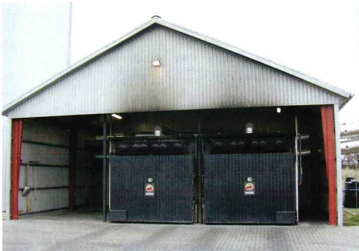
↑ Faustin 800 kilowatin kokopaalikattilat odottavat lisää poltettavaa. Varaajasäiliö vasemmalla.
