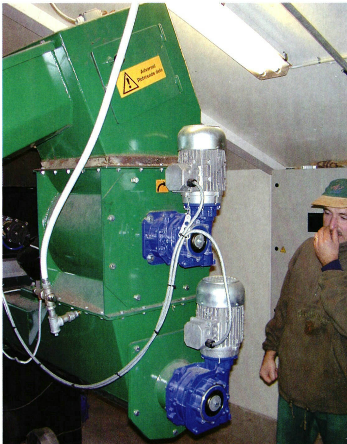
↑ Olkisilppu siirtyy ruuveilla kattilaan, kun niiden halkaisija on tarpeeksi suuri. Keskellä lokerosyötin, joka estää takapalon synnyn.
