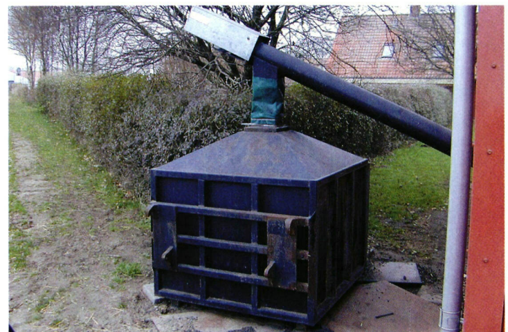
↑ Tuhkanpoistoruuvi siirtää tuhkan kattilan pohjalta etukuormaimella tyhjennettävään laatikkoon.
