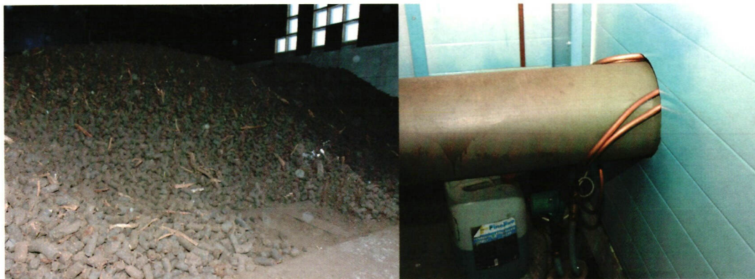
↑ Savuhormin vaipan lämpö siirretään kupariputkissa kiertävällä vedellä polttoainevaraston alle. Lattia-lämmityksen avulla sulamisvesi myös haihtuu.
