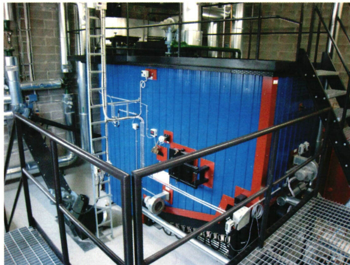
↑ Kiinteän polttoaineen kattilalla tuotetaan 95 prosenttia tarvittavasta lämpöenergiasta. Verkostovesi kiertää öljykattilan kautta pitäen sen kuumana. Kattilan hyvän säätävyyden ansiosta haketta voidaan käyttää myös kesälämmitykseen.
