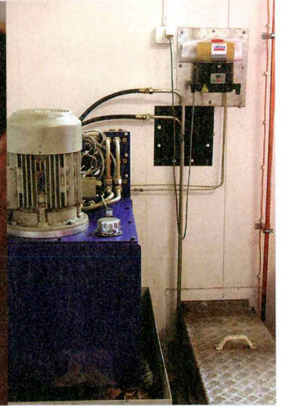
Tankopurkainten hydraulikoneikon alle on asennettu vuotoallas. Mikäli johonkin tankopurkainpariin tulee häiriö, kuten letkurikko, sen piiri kytkeyty irti automaattisesti muiden jatkaessa toimintaansa. Häiriöstä tulee luonnollisesti hälytys kännyköihin.
