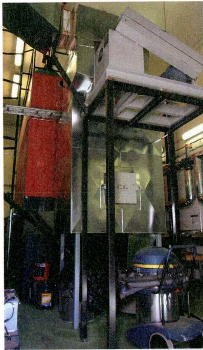
Kattilahuoneessa on tilaa liikkuu. Etualalla savukaasun suodatin. Toisen, pienemmän kattilan hankinnassa kontti on yksi mahdollinen vaihtoehto.
