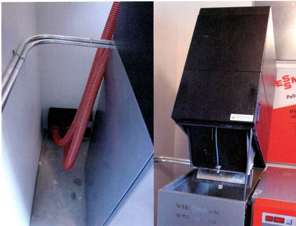
Polttoainesäiliön päällä olevassa kammiossa on imuri, joka ajoittain ottaa varastosta uutta polttoainetta säiliöön. Imuria voidaan käyttää tarvittaessa puhaltimena, jos imuaukot menevät tukkoon.
