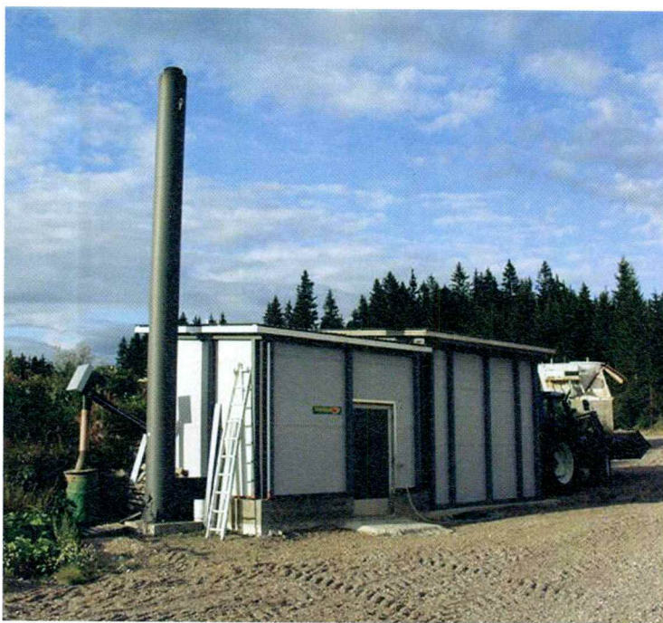
Kattilahuone pysyy paikallaan.
