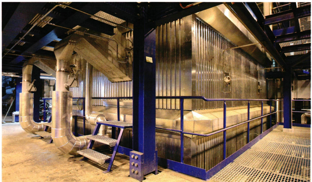
↑ Uuden kattilan polttoaineteho on 52 megawattia. Kuva: Heikki Löflund
