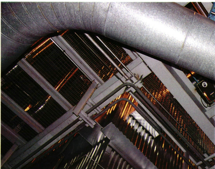
↑ Voimalan kattila on rakennettu ylhäältä alaspäin riippuvaksi. Biomassan palaessa koko kattila huojuu muutamien senttien liikettä. Hakevarastossa on kaksi kolakuljettimin varustettua ja purkaus- ja syöttölinjaa.
