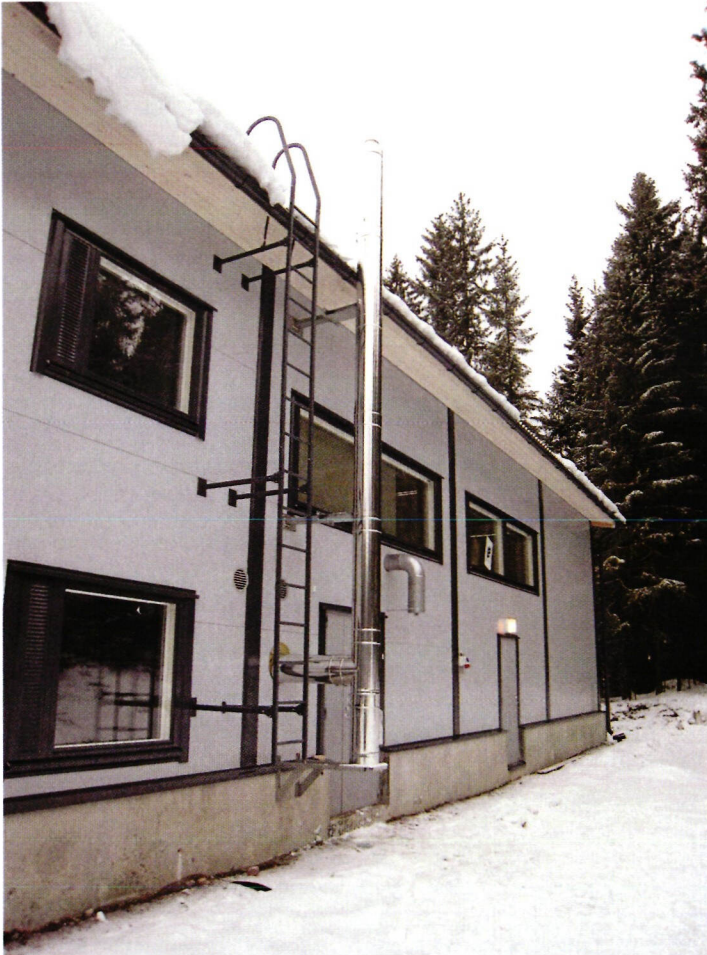
↑ Savupiippu suojattaneen vielä lumiasteella. Rosteripiipun takana pellettisäiliön poistoilmahormi. Herzin elementtipiippujen sisävaipan vahvuus on 0,6 millia. Välissä on 50 millin eriste, ulkovaipan paksuus on niin ikään 0,6 millia.
