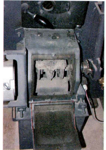
Ketjuarinan moottori käyttää savukanavien puhdistuskierukoita räikkäkytkimen välityksellä. Karkea tuhka jää arinaketjun päälle ja putoaa tuhkalaatikoon, savukanavista ja arinan lävitse variseva hienojakoinen tuhka päätyy erilliselle tuhkaruuville.
