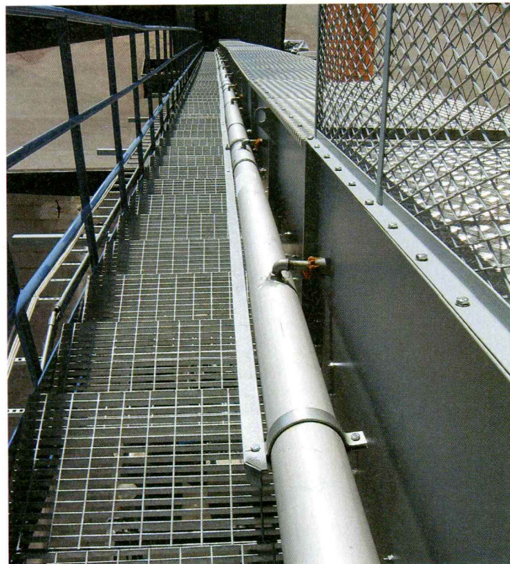
Sprinklaus kattilarakennukseen vievissä siirtokuljettimissa varmistaa paloturvallisuuden.
