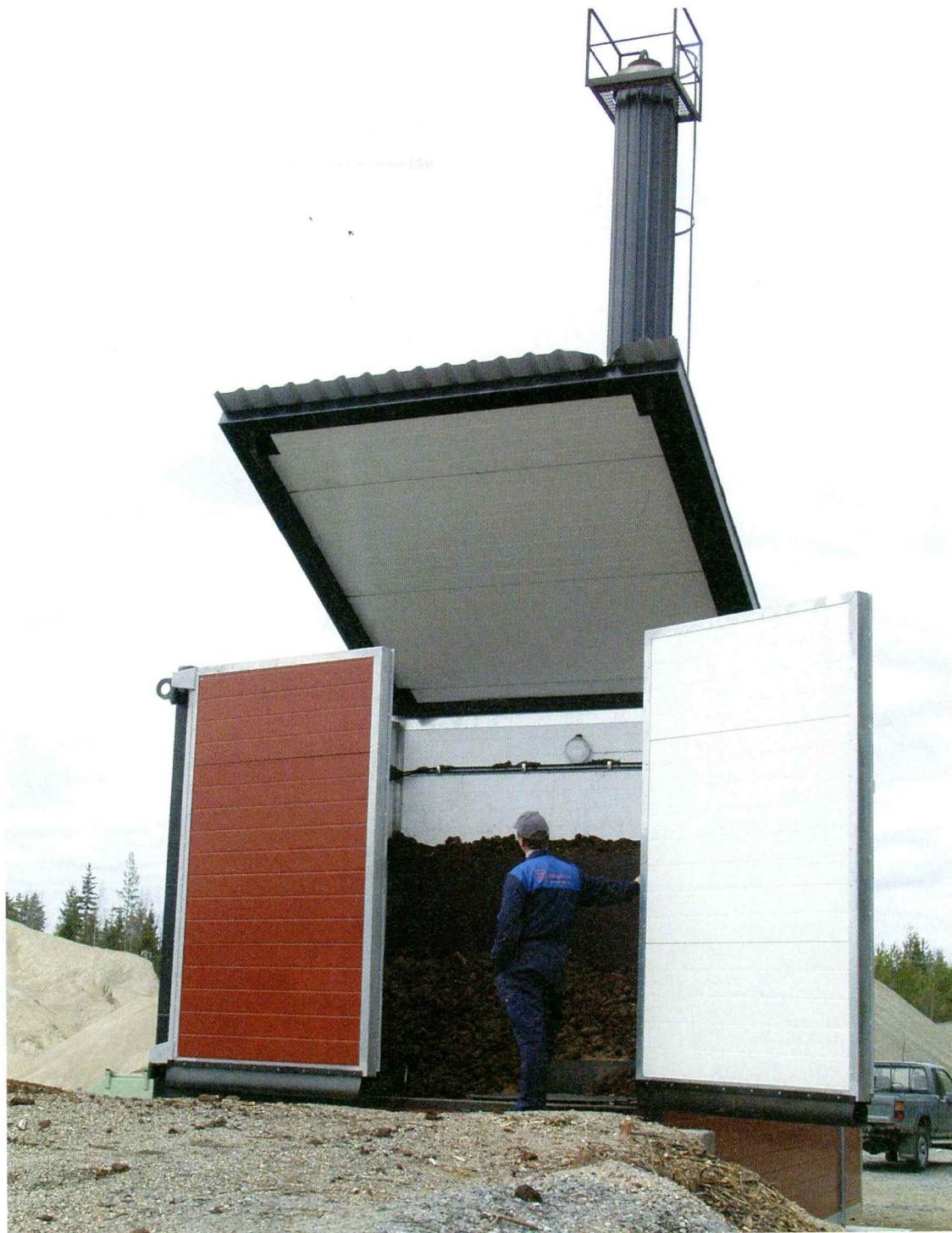
Kontissa olevalla kattilalla ladataan öisin 10 kuution varaajaa, jotta kuumaa vettä olisi käytössä riittävästi töiden alkaessa. Siiloon mahtuu 20 kuutiota polttoainetta.
