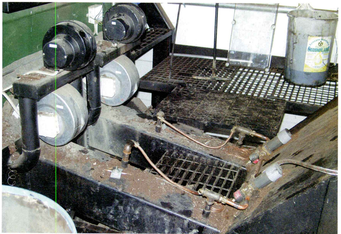
Kattilassa on kaksi palopäätä ja kaksoisruuvi. Jos toinen menee häiriöön, toinen on käytettävissä ja jos taas tehontarve putoaa, tullaan toimeen yhdellä ruuvilla.
