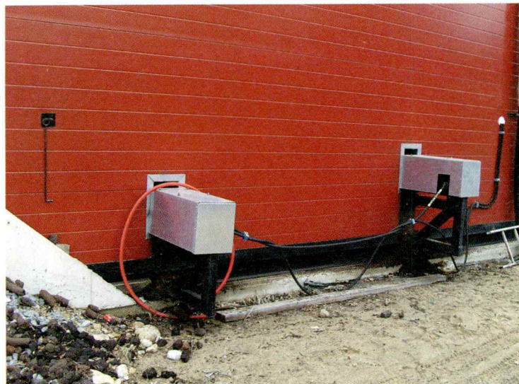
Tankopurkaimen sylinterit kaatoivat kontista toisen seinän. Nyt sen rakenteet on vahvistettu niin, ettei rasitus kohdistu seiniin.
