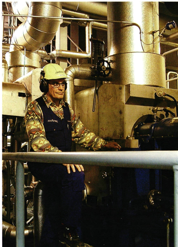
↑ Biokraft Oy:n voimalanhoitaja Raine Aronen höyryturbiini-sähkögeneraattori-yhdistelmän äärellä.
