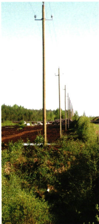
↑ Sähkölínjan vetäminen turvetuotantoalueelle maksaa muuntajineen yleensä yli 20 000 €/km. Kuva: Lauri Ijäs
