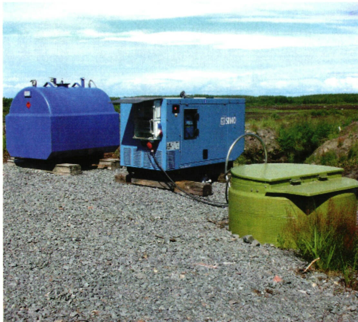
↑ Dieselaggregaattiin perustuva pumppaamo maksaa keskimäärin 12 000–20 000 euroa. Kuva: Lauri Ijäs
