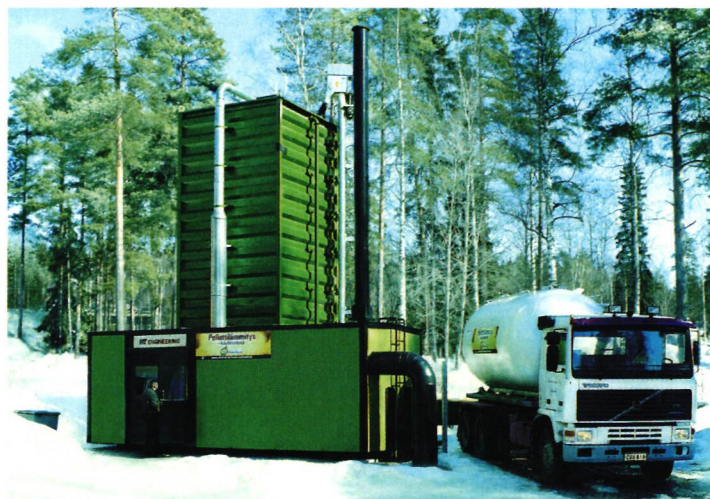
↑ Haapamäen keskustan pelletillä toimiva lämmityskontti on ollut toiminnassa vuodesta 1999.
