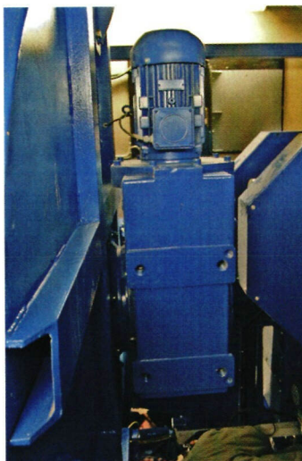
Kaapimia pyörittää puhuttelevan kokoinen ja näköinen kulma-vaihte
