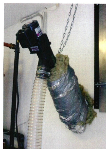
↑ Polttoaineruuvu on paloeristetty palotarkastajan vaatimuksesta.
