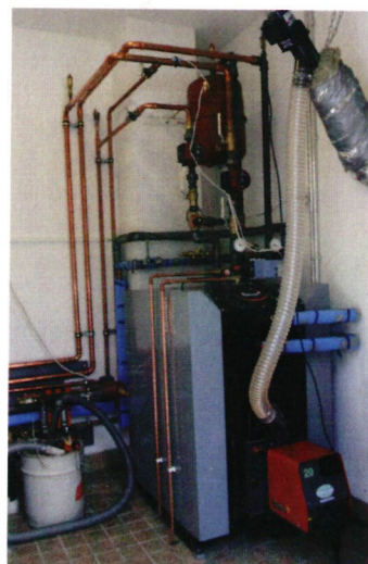
↑ Poltin kääntyy oikealta vasemmalle, syöttöruuvi ei peitä kulkutietä, kattilan sivulla ja päällä on riittävästi tilaa. Tilankäyttö on tehokasta.
