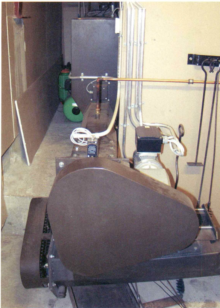
Tankopurkaimen syöttökotelossa on kaksi valosilmää ohjaamassa purkaimen käyntiä. Sulkusyöttimen kannen päällä on mikrokytkin. Kannen noustessa syöttö katkeaa. Yläruuvien päähän on kiinnitetty kaksi kumiläppää, jotka estävät ilmanpääsyn polttoainevaraston suuntaan. Jos omavoimaisen termostaattiventtiilin anturit havaitsevat lämpötilan syöttöputkissa nousevan, ne käynnistävät vesisammutuksen.
