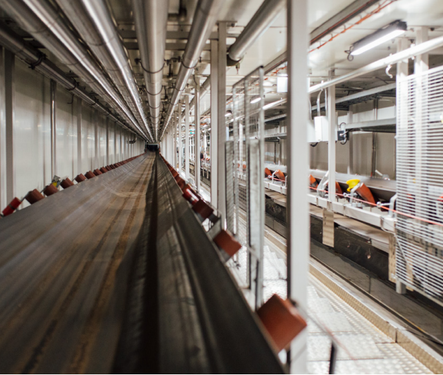
Polttoaineen kuljettimissa vasemmalla kulkee hake ja oikealla SRF-polttoaineet.
