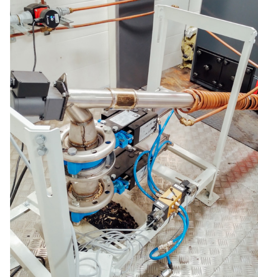
Biohiilen poisto- ja jäähdytysjärjestelmä.
