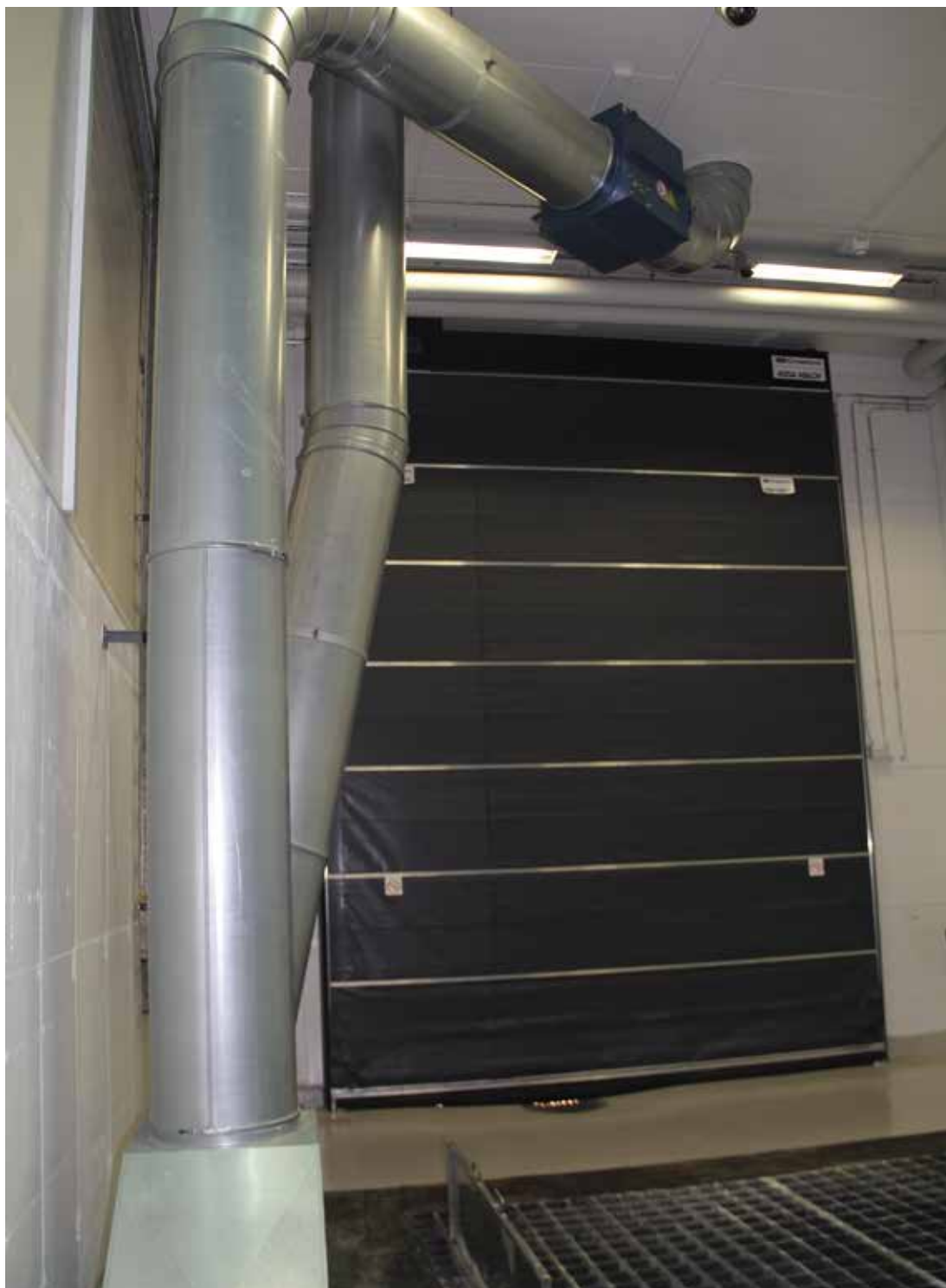
↑ Purkuaukon kiinteä alapoisto vähentää pölyn leviämistä. Suojaritilä estää työntekijän putoamisen purkuaukkoon. Kuvat Juuso Loukola ja Bestin tutkijaryhmä
