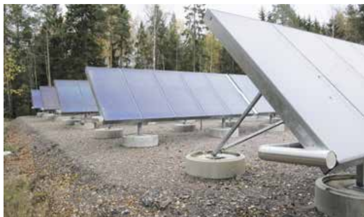
Uusin aurinkolämpöjärjestelmän toteutus on helsinkiläisessä Sakarimäen koulussa, jossa 160 neliometriä aurinkolämpökeräimiä lämmittää koulun lämpöverkkoa yhdessä lämpöpumpun kanssa.
