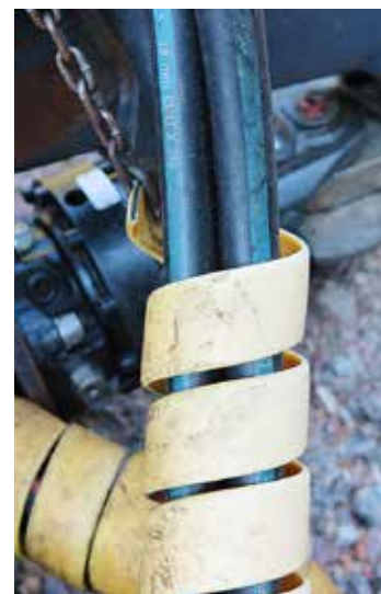
↑ Sähköjohdot ja suojaimet pitää tarkistaa säännöllisesti ja vaihtaa heti, kun tarvetta ilmenee.
