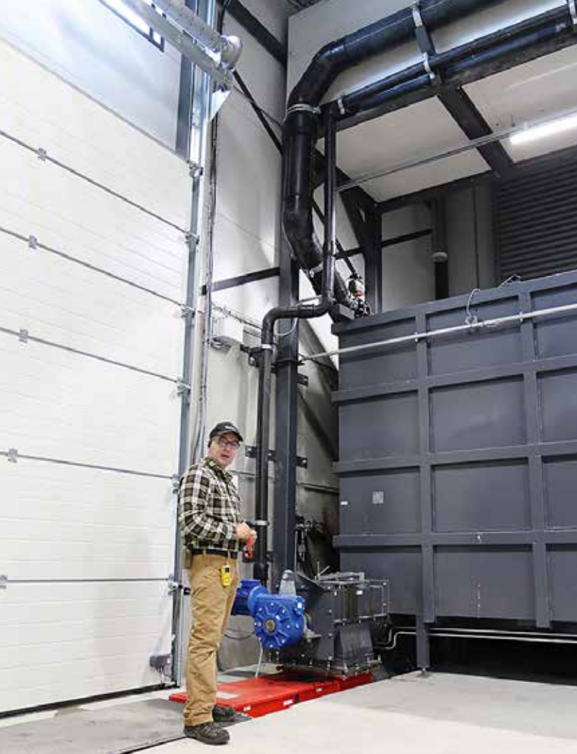
↑ Mäntäpumppu siirtää lantamassan vastaanottokontin päällä olevan hygienisointiyksikköön, esittelee Kalle Mattila.
