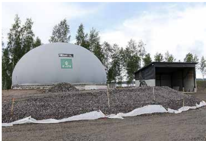
↑ Kaasukupu on lietesäiliön päällä. Kuivajae välivarastoidaan vieressä olevassa katoksessa.
