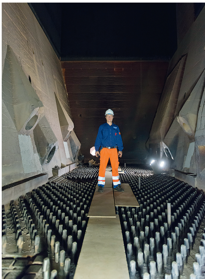
↑ 490 MW:n kiertoleijukattila turpeen ja puun polttoon. Kuva: Jyväskylän Energia Oy.
