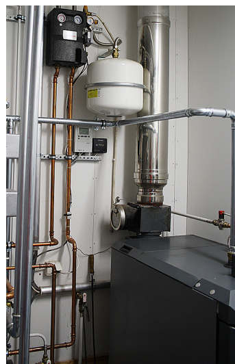
↑ 3000 litran vesivaraaja on tärkeä osa järjestelmää.
