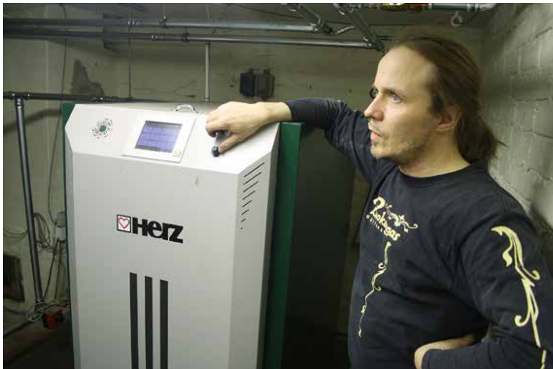
↑ Pannuhuoneen ja varaston laitteiden investointikustannus oli noin 15 000 euroa (alv 0). Riittävä teho maalämmöllä olisi Ruokankaan mukaan nostanut kustannukset kolminkertaiseksi.
