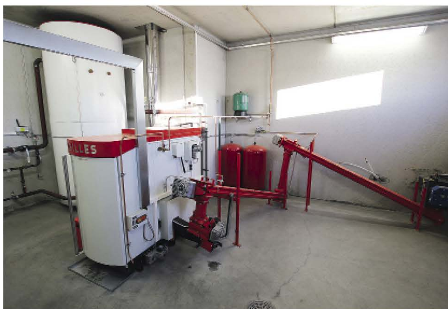
↑ Kattilahuoneessa on hyvin tilaa vielä toisellekin kattilalle. Pitkät siirtoruuvit ja kaksi ilmahyppyä tuovat lisää paloturvallisuutta.
