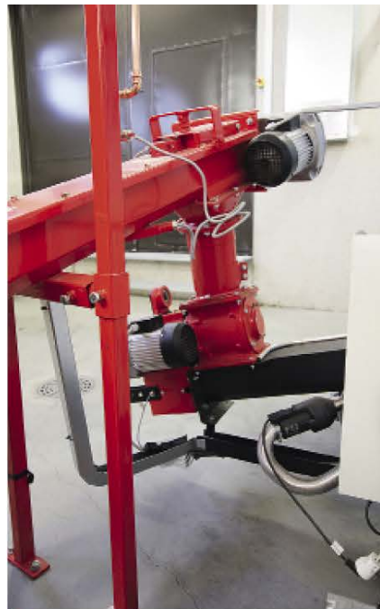
↑ Kattilaruuvien lokerosyötin varmistaa paloturvallisuutta. Automaattisytytys tehdään kuumailmapuhaltimella.
