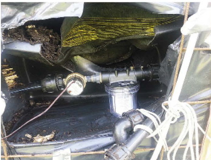
↑ Näin sijoitetaan putket biomeileriin: Kiertovesipumpulla säädetään lämpötila sopivaksi.
