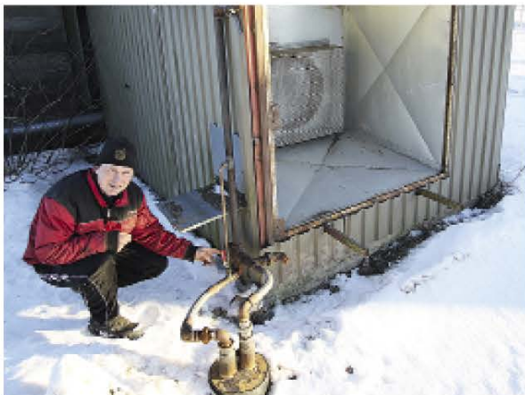
↑ Radiaattori kytketään kuivauskaudeksi kuivurin ilmanottoaukon eteen, esittelee Jani Häkkinen. Radiaattori nostetaan kattilahuoneeseen lämpimään tilaan talvikaudeksi.
