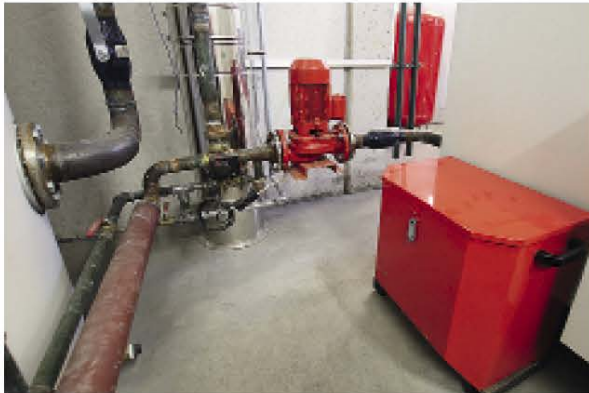
↑ Automaattinen nuohousjärjestelmä siirtää tuhkat siististi kannelliseen astiaan. Kiertovesipumppu on järeää tekoa.
