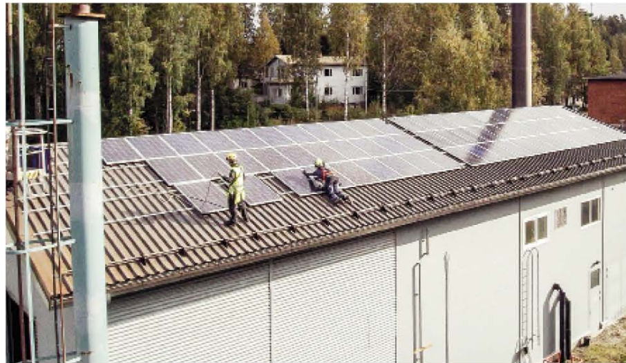
↑ Ei vain haketta. Enon Energia Osuuskunnan yhteen lämpölaitokseen asennettiin 21 kW aurinkopaneleita viime syksyllä. Tavoitteena korvata kallista ostosähköä. Kuva Mikko Tirkkonen
