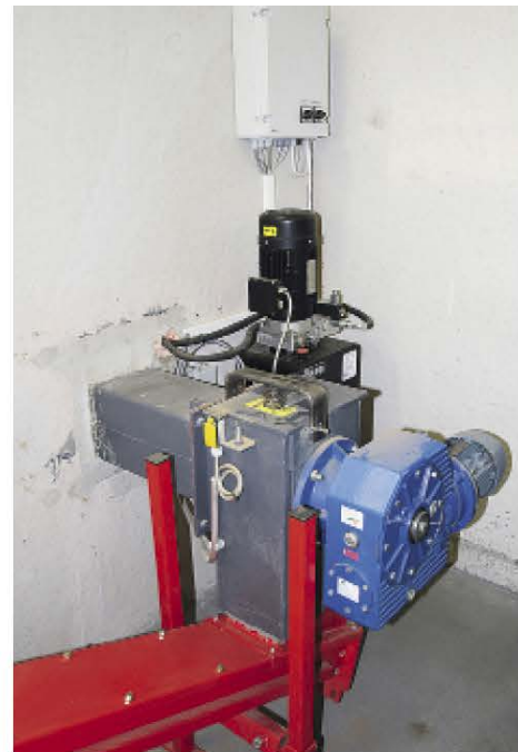
↑ Hakevaraston puolella on hydraulisesti käytettävä tankopurkain. Järeä, 150-millinen ruuvi tuo hakkeen kattilahuoneen puolelle. Hakkeen tuloa varastosta kattilahuoneen siirtoruuville vahtii valosilmä. Tarvittaessa siirtoruuvi saadaan vedettyä helposti ulos.
