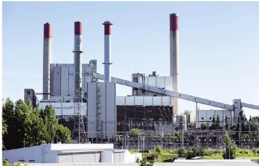
↑ Martinlaakson voimalaan kuuluu kaasukombilaitos, hiilikattila sekä uusi biokattila, joka korvaa vanhan kaasun- ja öljykattilan.
