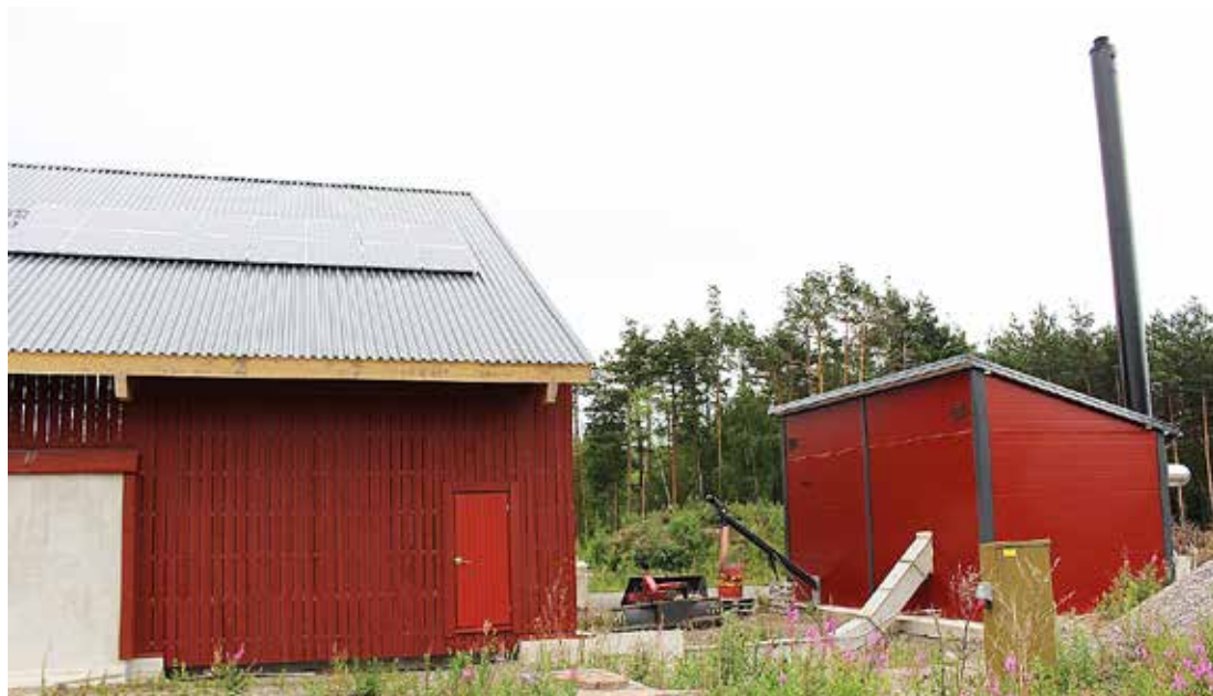
↑ Euran Energian omistamalla hakelämpölaitoksella aurinkopaneelit on asennettu hakevaraston katolle. Paneeleille edullinen kulma ja ilmansuunta huomioitiin jo rakennuksen suunnitteluvaiheessa. Kuva: TTS/Jim Antturi
