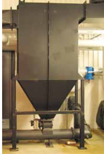
↑ Multisykloni vaadittiin pienhiukkasten puhdistamiseksi
